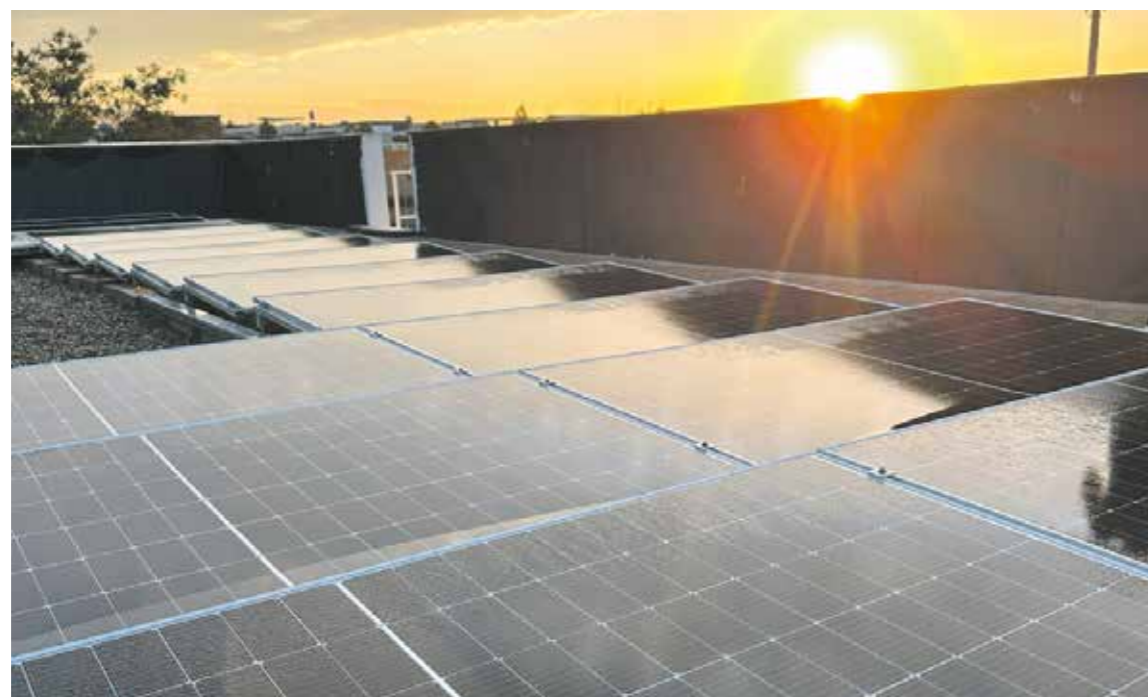
El grupo Fulton ha convertido sus oficinas centrales, que cuentan con el certificado BREEAM, en un recinto más sostenible tras la instalación de 72 módulos fotovoltaicos en la cubierta, una apuesta por el autoconsumo y la energía verde que cubrirá parte de las necesidades energéticas del edificio.
